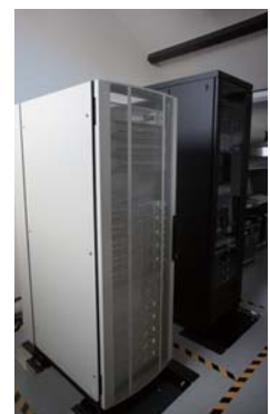
新サーバーーム
