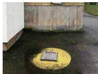
廃水漏洩防止用のカバー
