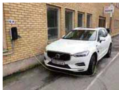
充電ステーション
